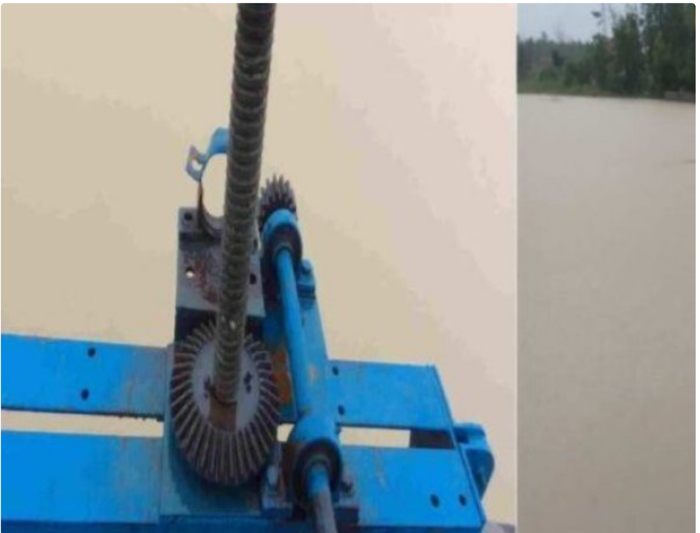
Pintu air Albaret Simpang Mesuji
